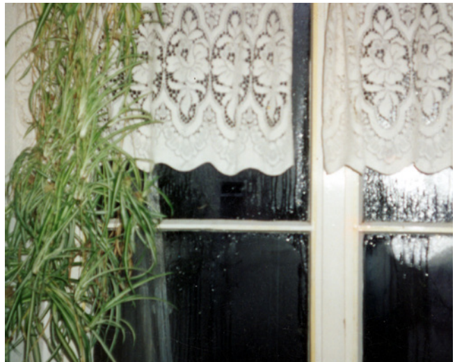
Ablaufendes Kondenswasser an einem einfach verglasten Fenster
