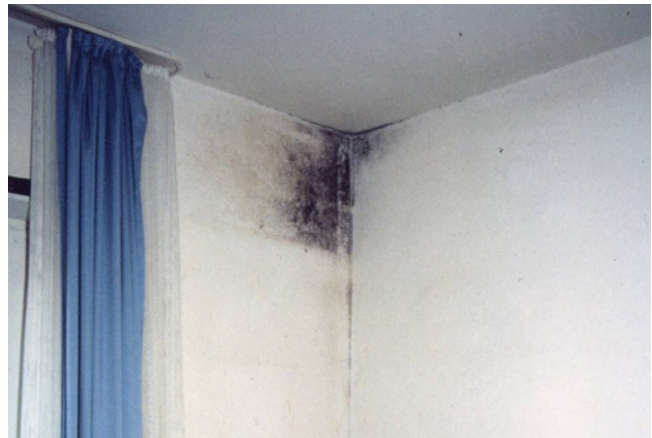
An einer durch Wärmebrückenwirkung eines Betonsturzes ausgekühlten Wandfläche schlägt sich Feuchtigkeit nieder. Der Schimmelpilz hat ideale Bedingungen für sein Wachstum.
