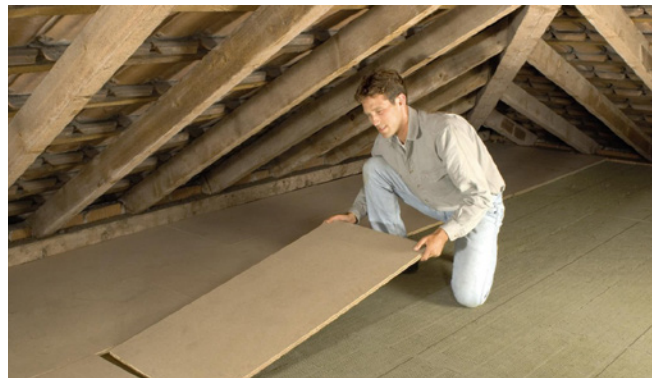
Wo häufiger auf Mineralfaserdämmplatten gelaufen wird, werden Hartfaserplatten o.ä. ausgelegt.
