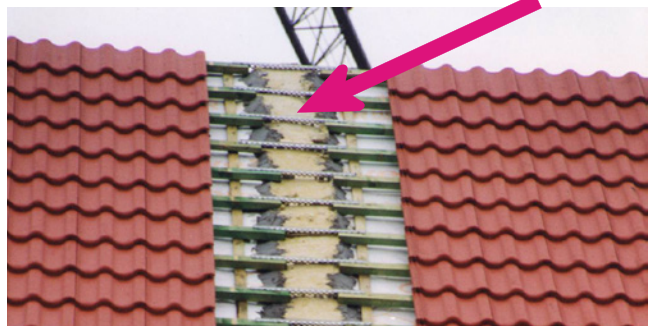
Die Dämmung und die Dachlattung über einer „Brandwand“ muss aus feuerfestem Material bestehen.
