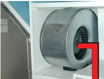
Ein Ventilator in einem Lüftungsgerät
