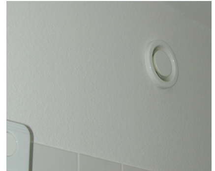
Abluftventil in einem Bad
